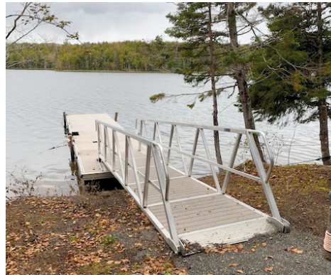
Un de nouveaux quais installés sur le Sentier à la Première Nation d'Eskasoni, Goat Island, N.-É.
